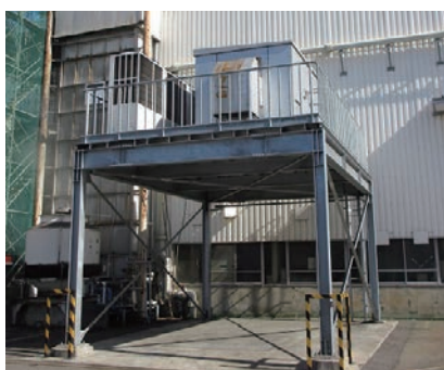
将土浦工厂的废热再利用于工厂内空调的机组
