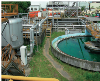
土浦工厂综合排水处理场
