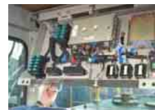
*照片所示为打开的电气配线盘。
